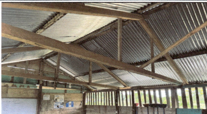
Foto 1: Actualmente cuatro aulas cuentan con estructura de techo de madera la cual esta deteriorada poniendo en riesgo a los niños que utilizan dichas aulas, por lo que se sustituirá por estructura de metal.
