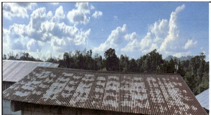
Foto 3: Vista de la cubierta de techo en mal estado. Se sustituirá por lámina troquelada Cal 26.
